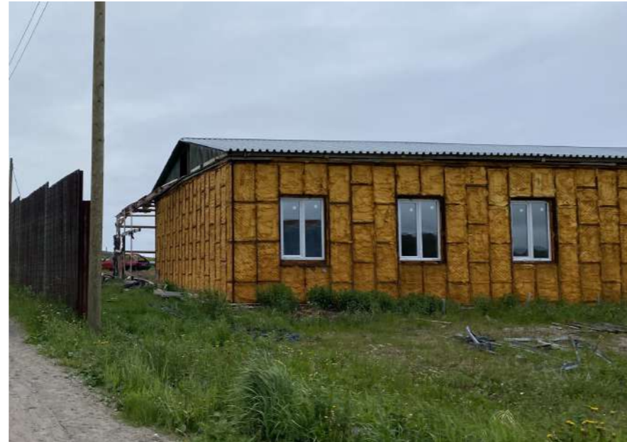
Плохо. На фасаде отсутствуют облицовочные материалы
