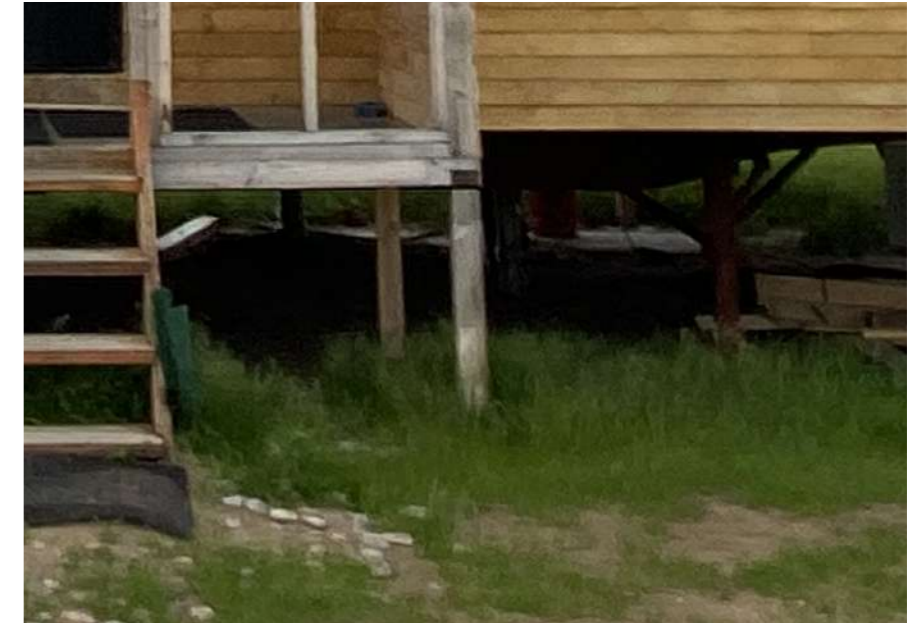
Плохо. Пространство под зданием открыто. Цоколь отсутствует
