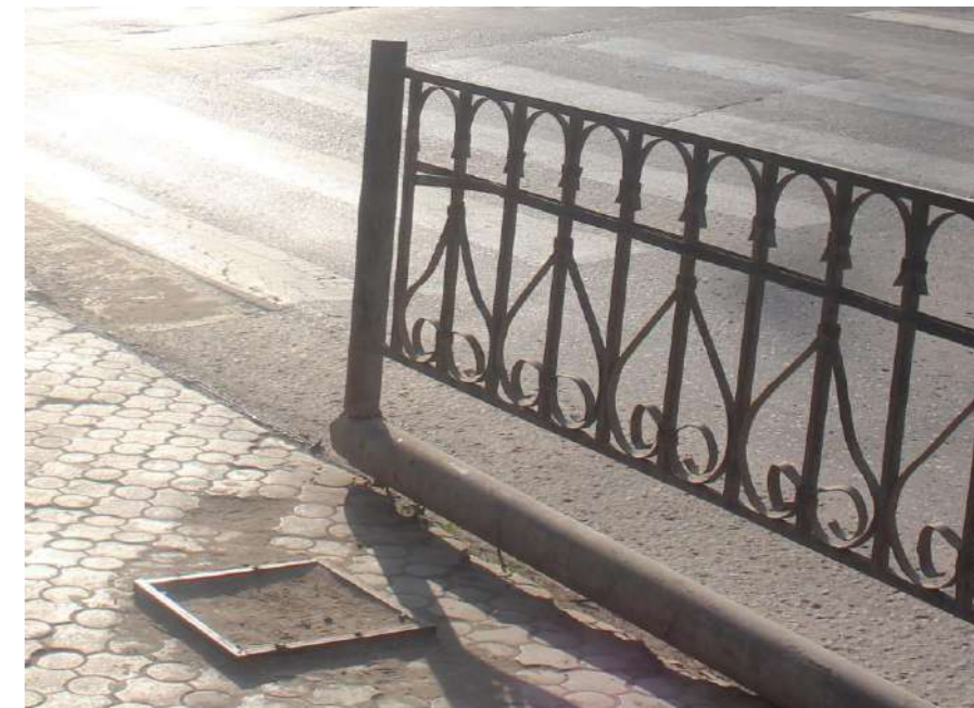
Плохо. Использование кованых элементов
