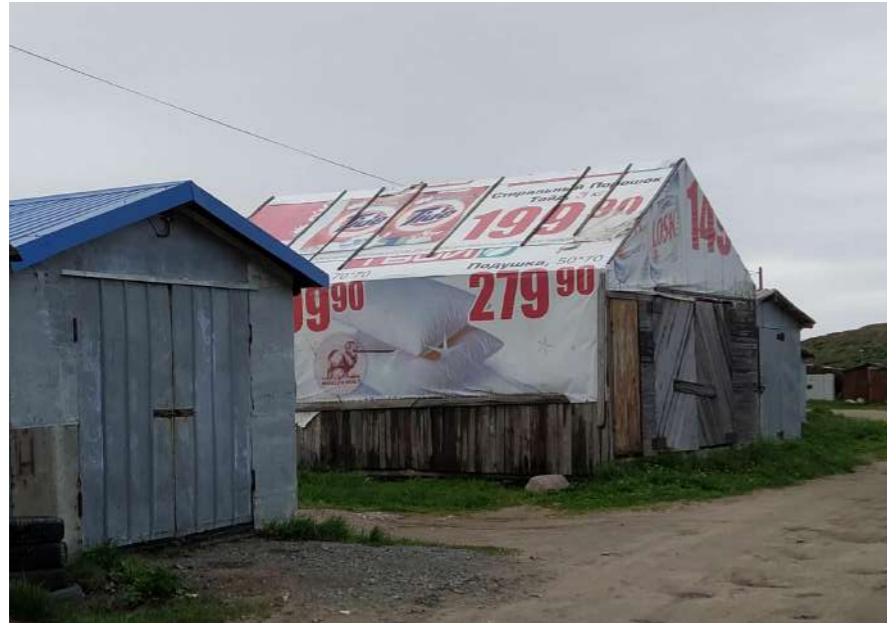
Плохо. Для ремонта использованы баннерные ткани
